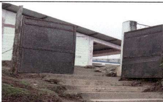
Foto 5: Sustrucción de puerta.
