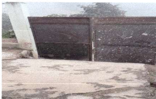
Foto 1: Sustrucción de puerta.
