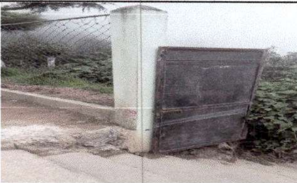
Foto 4: Sustrucción de puerta.
